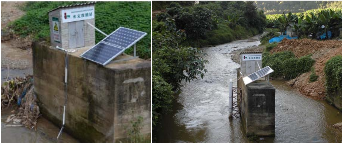
图 9 - 暴雨后洪水毁坏的 P4 水文监测站 (左) 修复后正常工作的 P4 水文监测站 (右)
